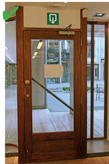
😊 Une issue de secours est prévue. La porte mesure 0,90 m de large, ce qui permet à une personne en fauteuil d'évacuer.
